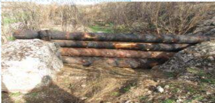
Retenção de materiais (após fogos florestais) – Seia /2010
